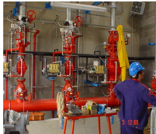
Köpüklü Sprinkler Sistemleri
