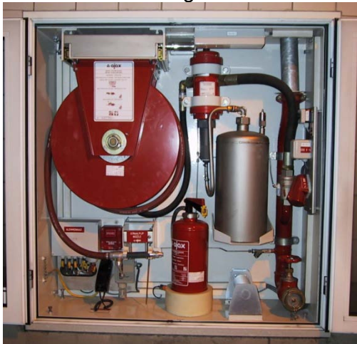
Köpüklü Yangın Dolapları
